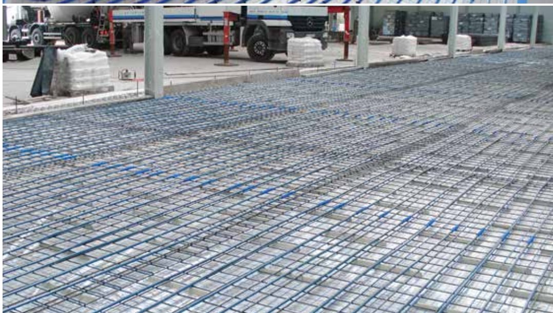
Joon. 4. Tööstushoone põrandaküttesüsteemis, milles kasutatakse blueFLOOR PERT torusid ja süsteemi KAN-therm NET.
